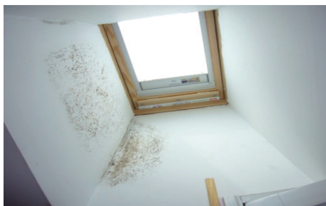
Rampant de toiture contaminé par les moisissures (doc. ESPACE9)
