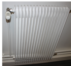
Radiateurs à eau chaude (doc. ESPACE9)
