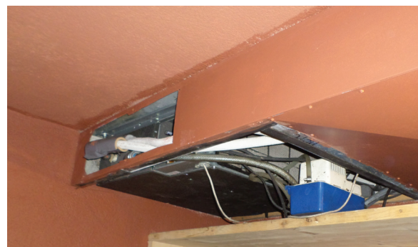
Unité intérieure gainable avec pompe de relevage pour l'évacuation des condensats (doc. PIERRE BARLES CONSULTANT)
