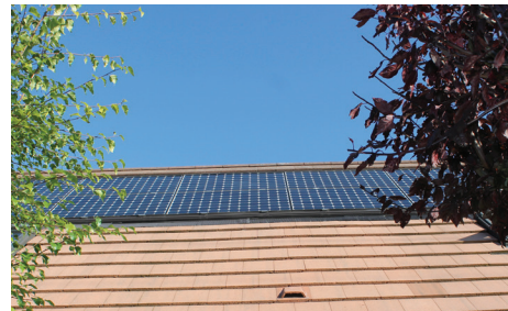
Technique n°4 : Système solaire thermique (doc. ESPACE9)
