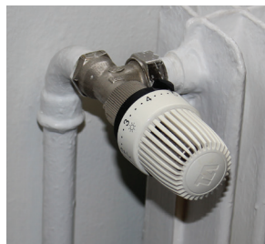
Système de régulation Canalisations et régulation (doc. ESPACE9)
